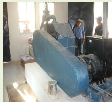
Casa de Máquinas: Turbina y Generador
