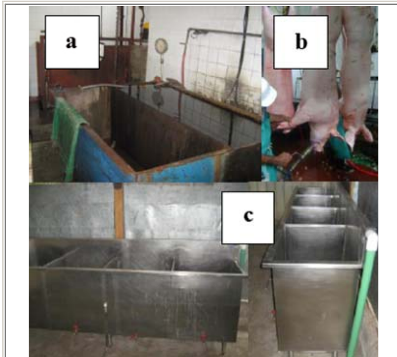
Figura 3. Uso del Biogás en la Planta de Matanza: a) escaldado para pelado de cerdos; b) Flameado de cerdos; c) sistema de cocción de vísceras y sangre.
