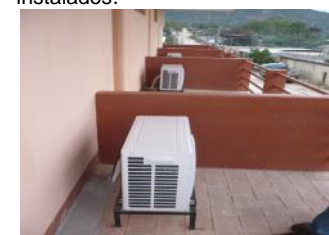
Foto 2. Nuevos equipos de A/A instalados.
